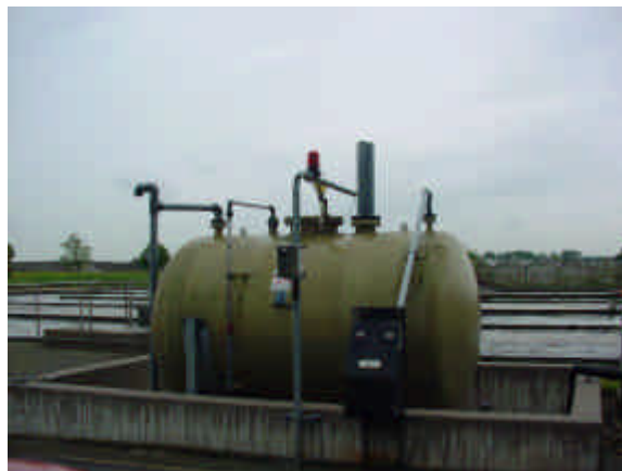
Figuur 15 - Chemicaliënopslag bij een zuivering
