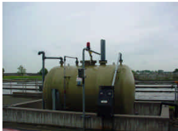
Figuur 15 - Chemicaliënopslag bij een zuivering
