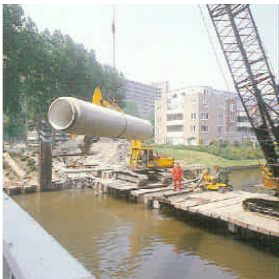
Figuur 11 - Riolering in een gracht.
