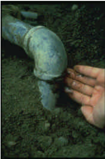
Figuur 4 - Lekkende leiding
