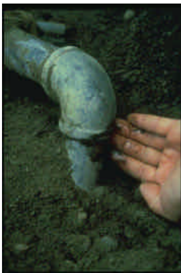
Figuur 4 - Lekkende leiding
